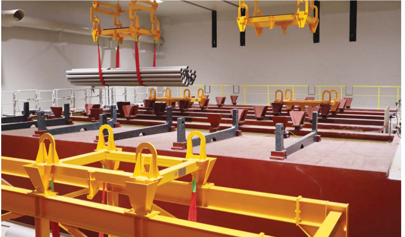
Zum Schutz der Mitarbeiter erfolgt die Be- und Entladung außerhalb der neuen Beizanlage. Foto: Butting
