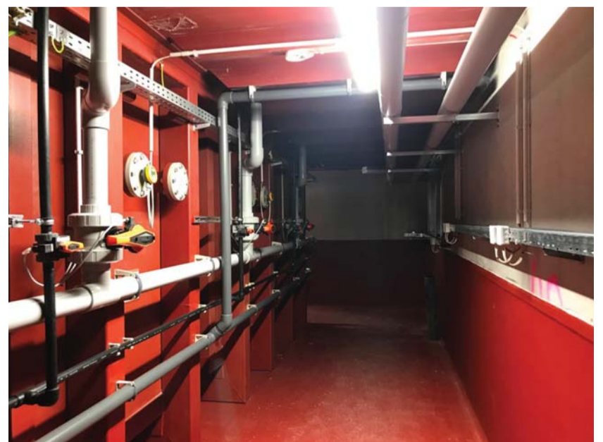
Der saubere und säurefreie Beizkeller ermöglicht den einfachen Einbau jeglicher Mess- und Regelgeräte. Foto: Butting
