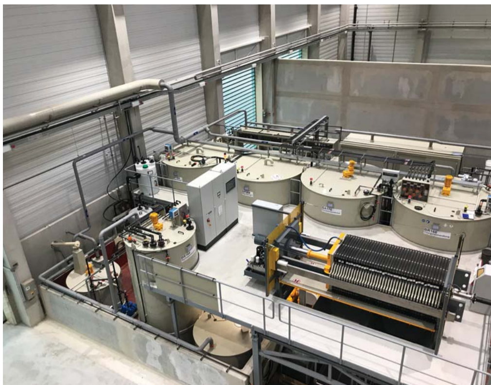
Alle Abwässer bei Butting werden durch die automatische Neutralisationsanlage gereinigt. Fotos: KVK Koerner
